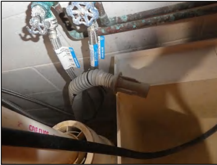
190. Missing stand pipe
